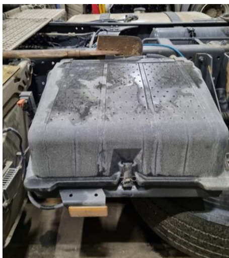
Рис. 1. Расположение аккумуляторных батарей и блока выключателя массы
