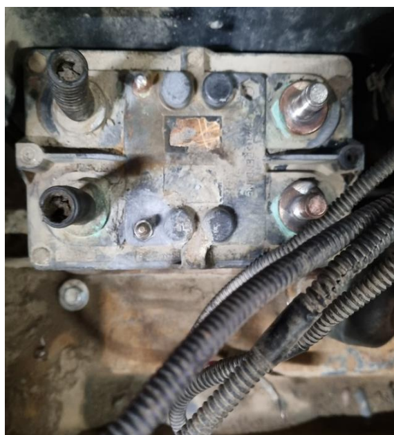
Рис. 2. Разрушение силовых контактов блока выключателя массы
