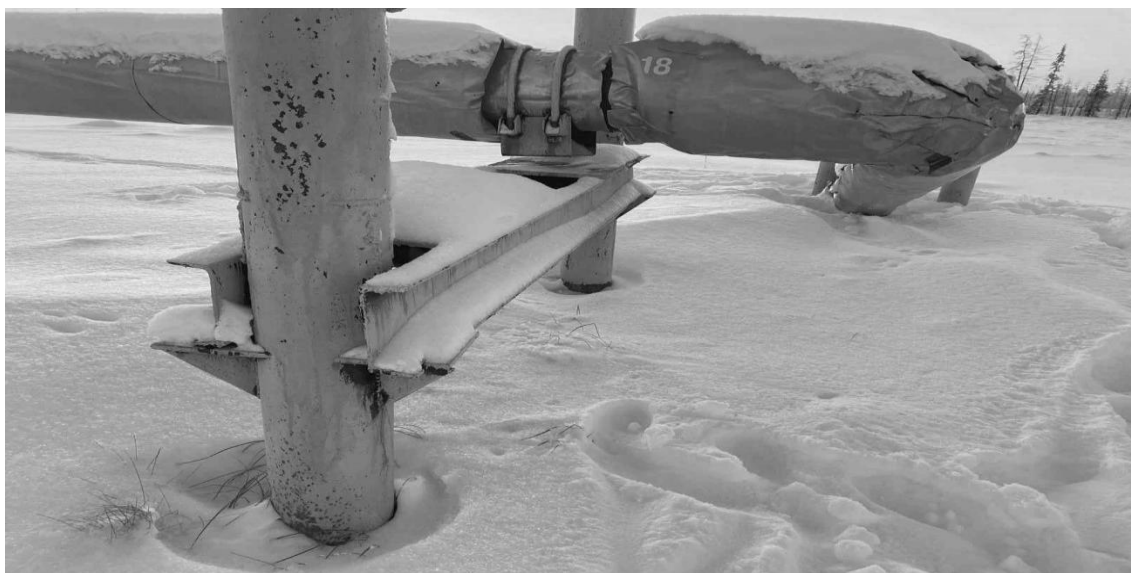
Рис. 3. Отсутствует опирание на опоре №18
