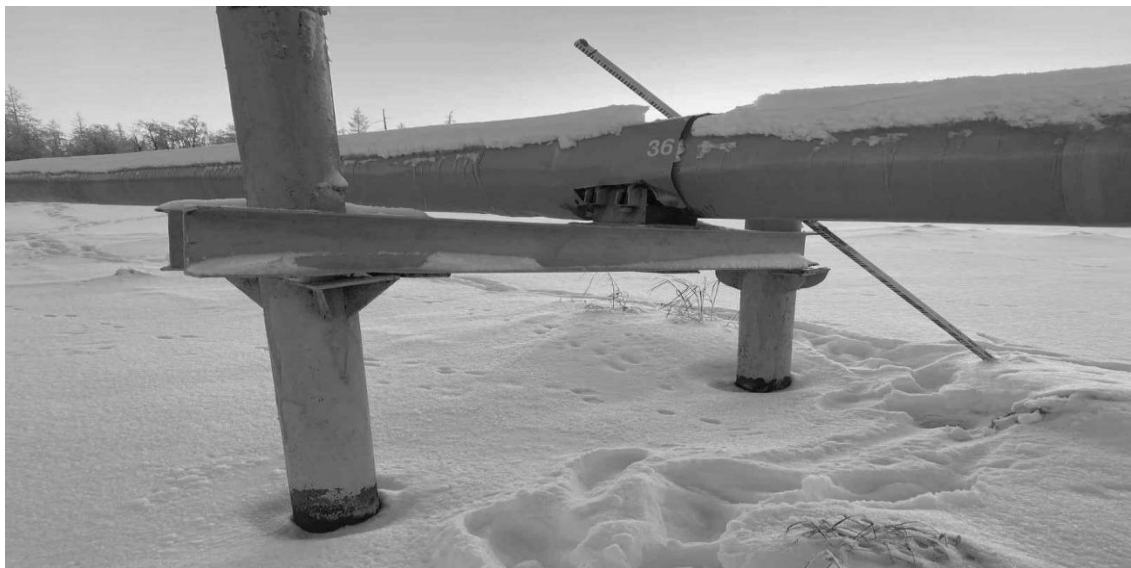
Рис. 2. Выпучивание свайных фундаментов
