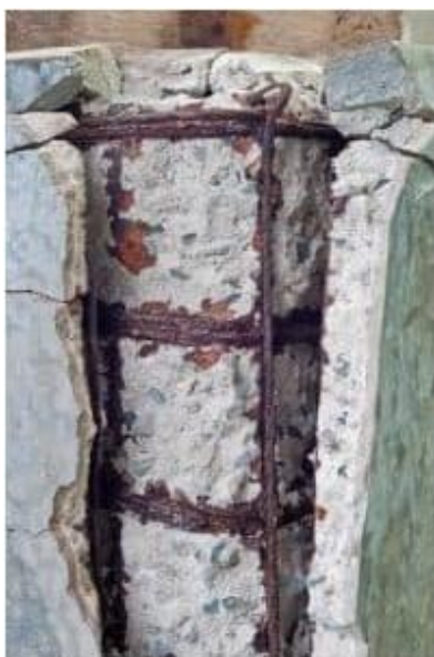
Рис. 3. Коррозия и оголение арматуры
