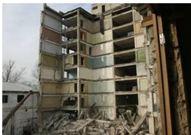
Рис. 2. Полное разрушение здания
