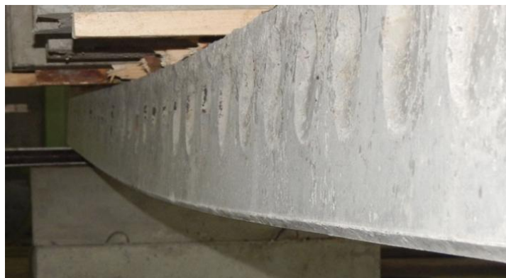
Рис. 4. Прогиб плиты перекрытия
